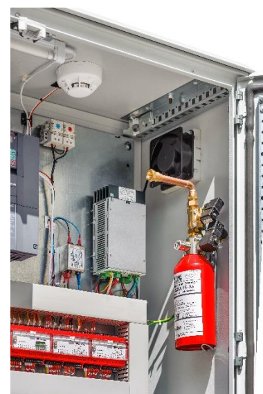
Rys. 13. SUG wewnątrz centrali.
